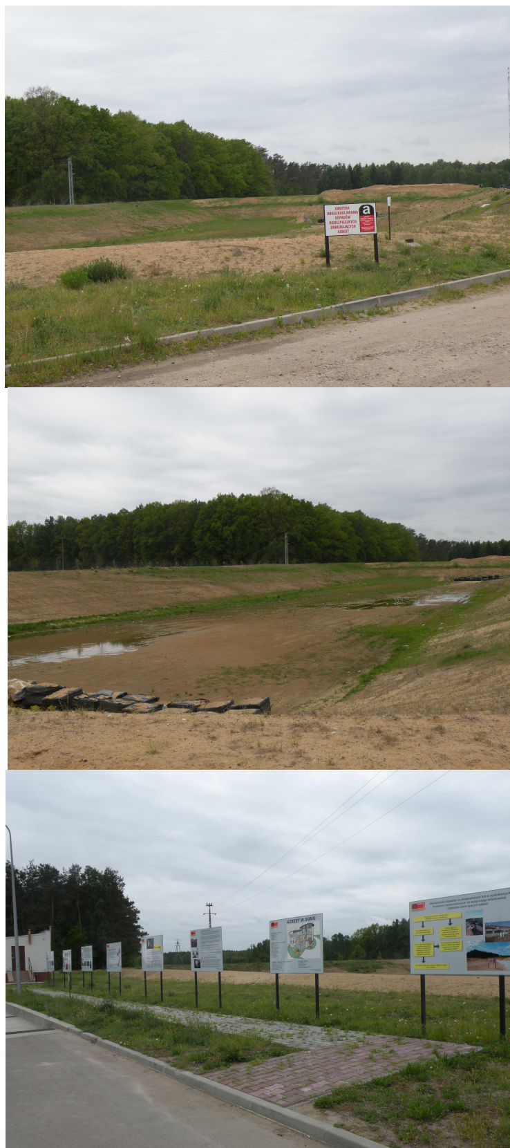
Ryc. 18. Niecka do unieszkodliwiania azbestu na składowisku odpadów innych niż niebezpieczne i obojętne w miejscowości Rachocin gm. Sierpc.
